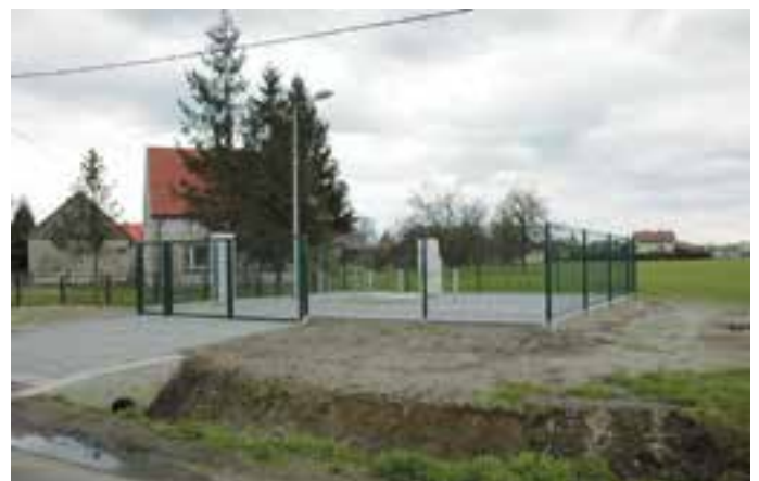
Przepompownia ścieków w Dziergowicach
